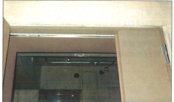
CRD-1 子扉が先に閉まった状態
